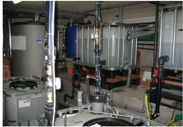
Betriebswassertanks, hinten zentraler Wärmespeicher und Urintank (blau)
