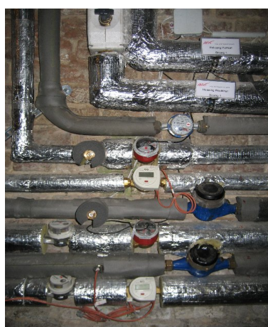
Leitungen und Messeinrichtungen
