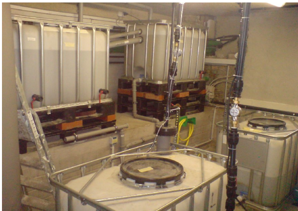
Betriebswassertanks mit zwischengeschalteten Membranfiltern
